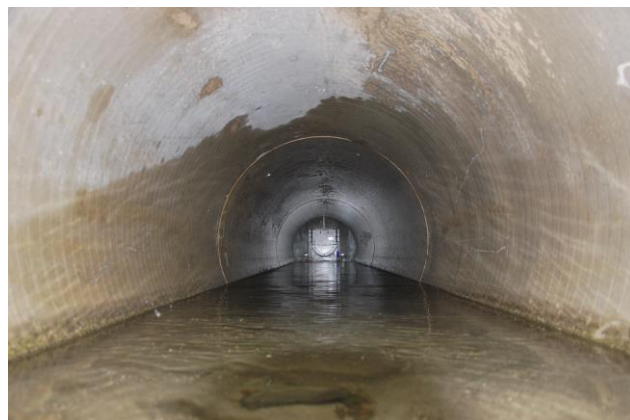
Udløb med konstant flow gennem rørlagt vandløb
