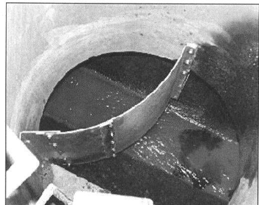
HydroStyx Regulatorenhed indbygget i eksist. brønd
