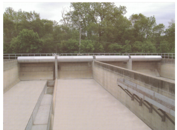
Bassin med HydroSelf VIP vippekar i sektionsopdelte kamre.
