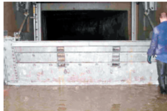
HydroGuard indbygget i eksisterende kloakledning
