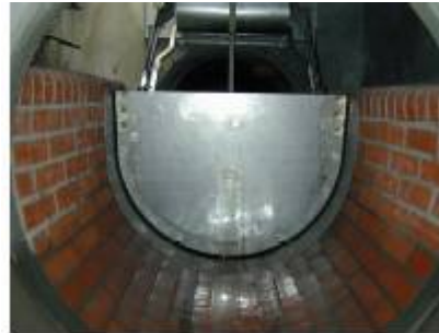
HydroFlush GS indbygget i eksisterende kloakledning
